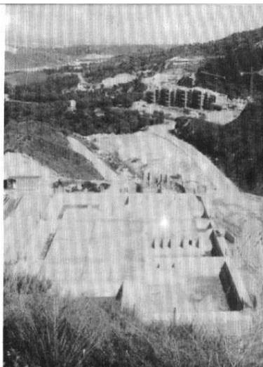
La Pretura di Corigliano: una struttura i cui lavori sono fermi ormai da anni nel disinteresse generale.
