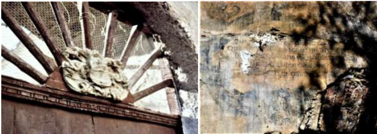
In alto: il portale (foto del 1987), l'artistico battente (rubato nel 2000) e il suggestivo atrio Al centro: particolare dello scalone e decorazioni interne corrose dalla muffa (foto del 2002) In basso: stemma che sovrasta l'ingresso all'orto e iscrizione in latino su una parete dello stesso
