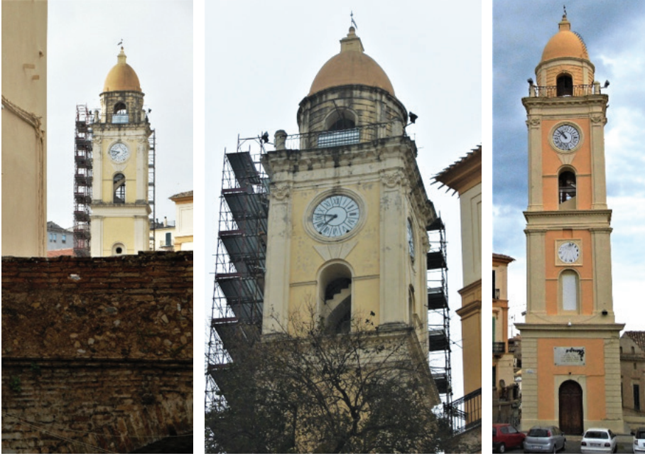
Figg. 61, 62, 63. Alcune immagini dei continui restauri che si sono resi necessari, l'ultimo dei quali ha avuto luogo nel 2010. La foto di destra raffigura la Torre come si presenta oggi.
